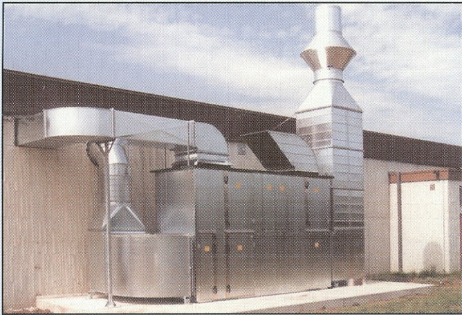
Be und Entlüftungsanlage für Schweißwerkstatt V= 15.500 m 3 /h
